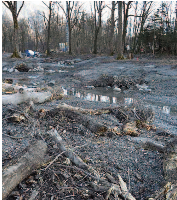
Noch ist es relativ trocken. Am kommenden Mittwoch findet dann die Gewässereinleitung in das neue Bett des Werdenberger Binnenkanals statt. FOTOS: ZVG
